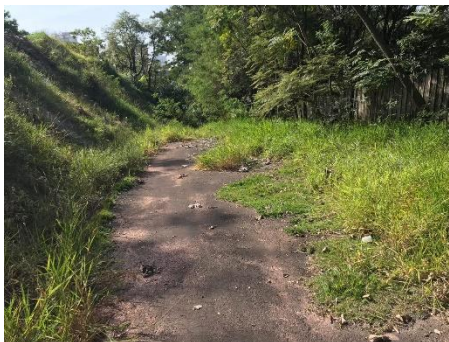
Figura 5- Pavimentação Asfáltica existente à ser demolido.
